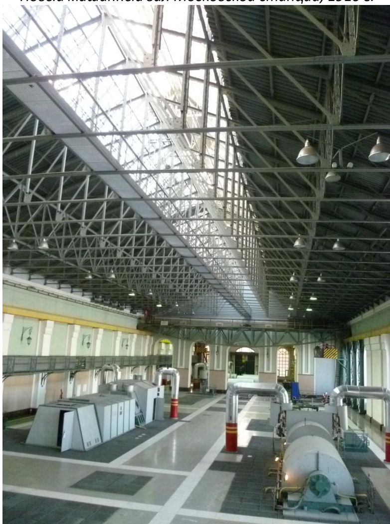
Машинный зал ГЭС-1, 2014 г.
